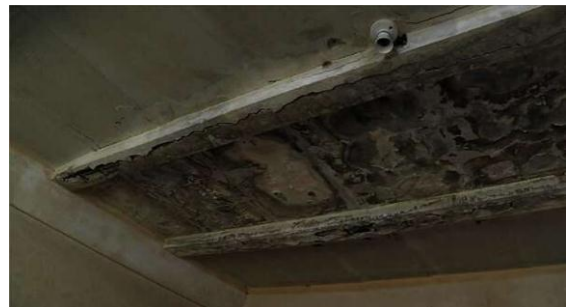
L'état des toits des salles de soin
